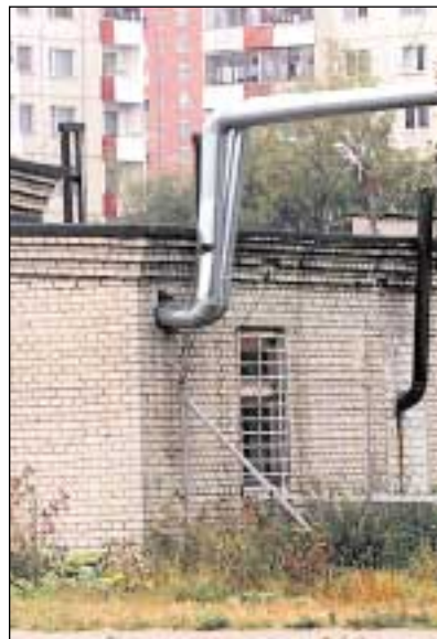
See Punase tänava boilerijaam jääb esialgu alles.
