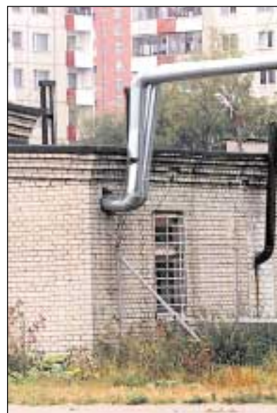
See Punase tänava boilerijaam jääb esialgu alles.
