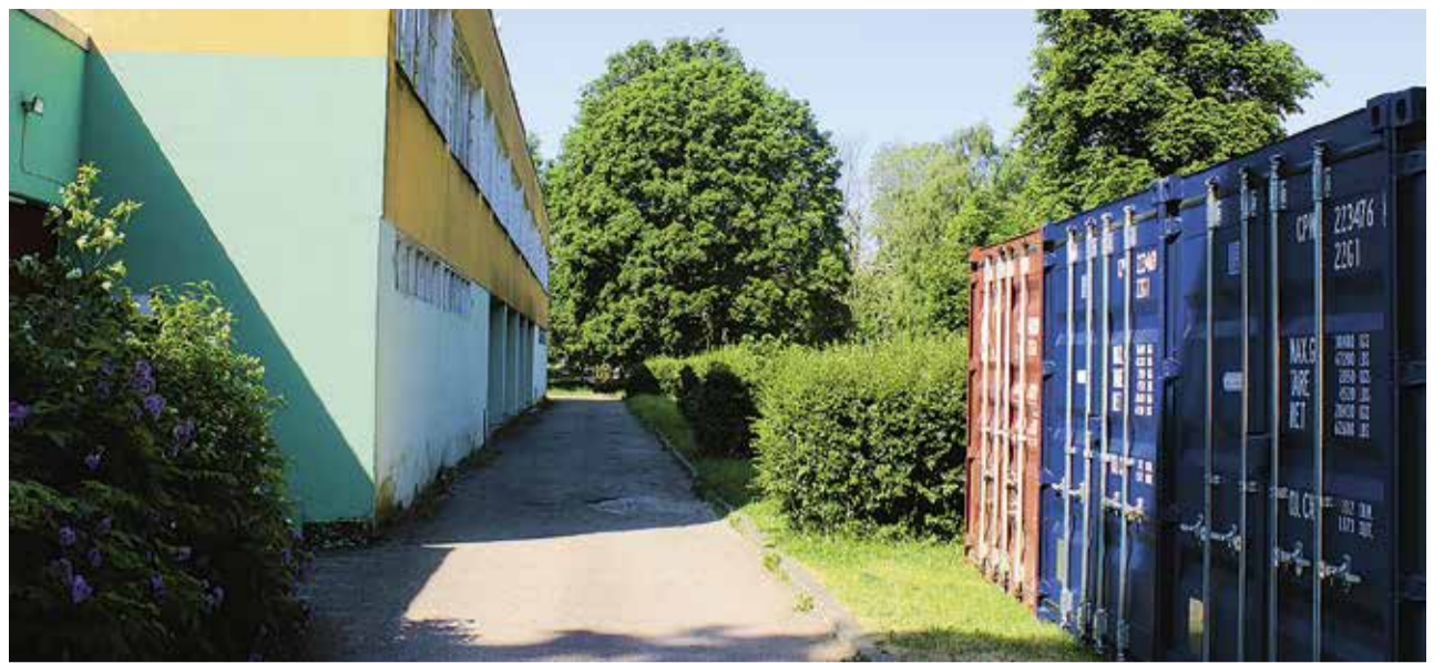
В ремонтируемом корпусе «В» по адресу Ыйсмяэ теэ, 24 разместится молодежный центр, который откроется в августе 2021 года.
