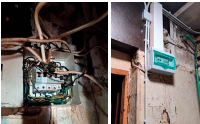
На фото электросистема связанной с проектом квартиры до и после ремонта.
